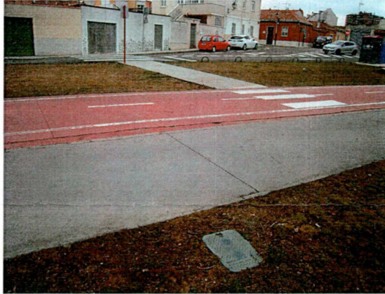
SENDA PEATONAL, CARRIL BICI Y COMUNICACIÓN CON PASO PEATONES VIRGEN DEL BREZO
