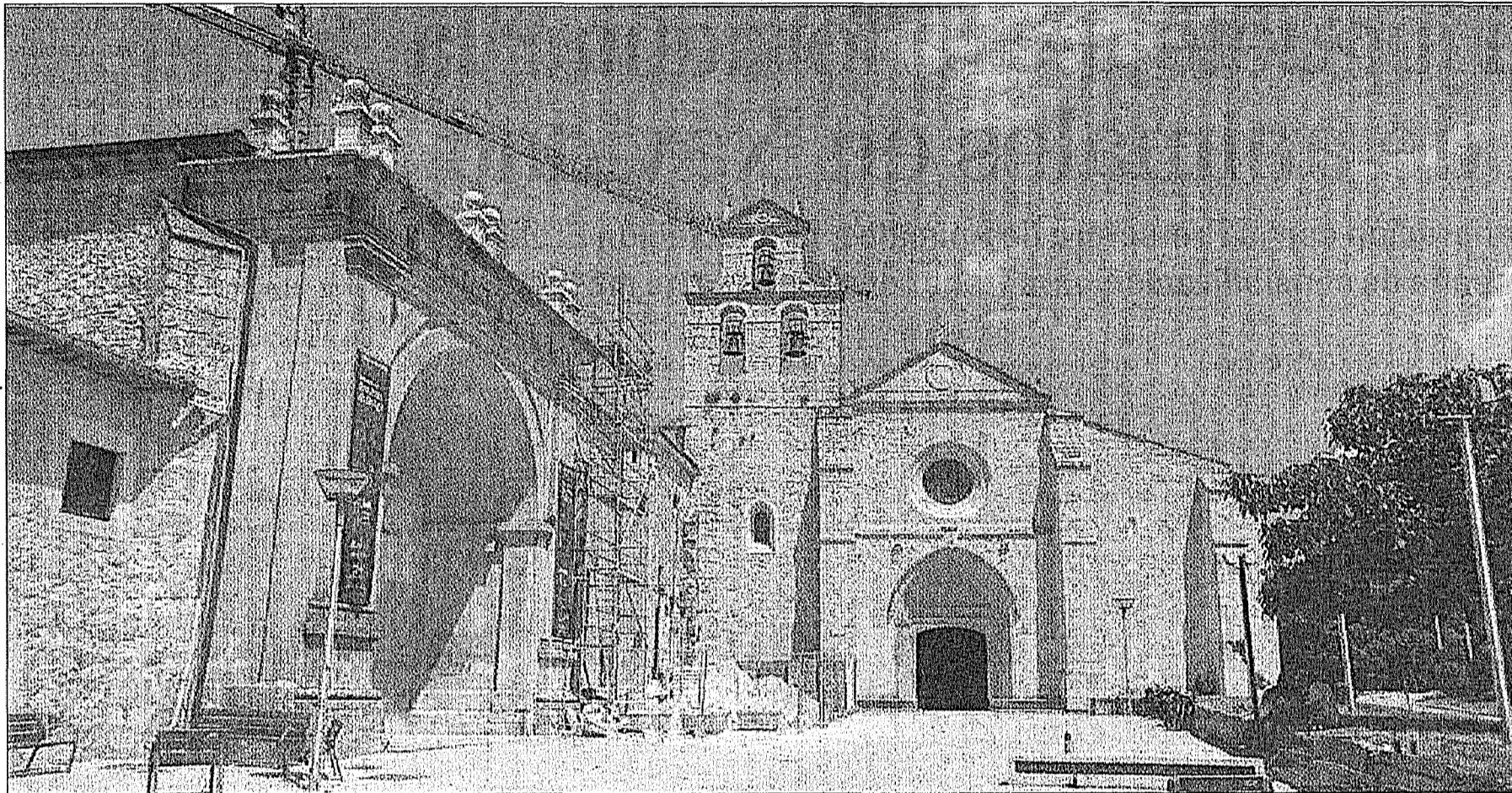
Aunque las obras van a buen ritmo, el Ayuntamiento critica que en éstas se ha elevado un metro la cubierta y se han colocado canalones no permitidos por ley. M. M.
